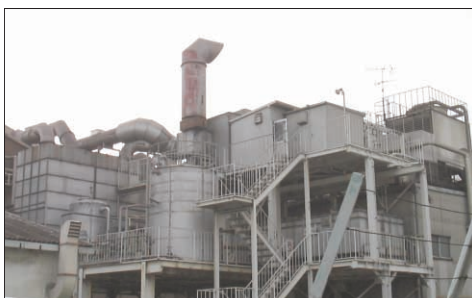
蓄熱式脱臭装置
