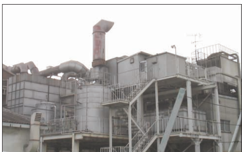
蓄熱式脱臭装置
