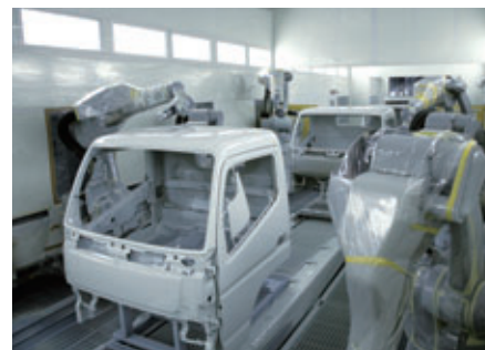
自動車業界初ともいえる「塗装ブース排気処理装置」を備えた塗装ブース。ブース内で発生するVOC(揮発性有機化合物)は塗装工場内に排出されず、すべて回収ダクトより集められ、無害化される。
