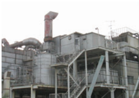
蓄熱式脱臭装置
