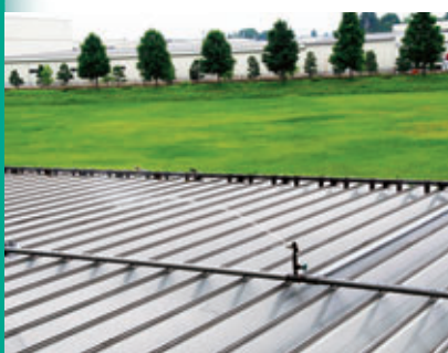
工場の屋蓋に設置されたスプリンクラー
