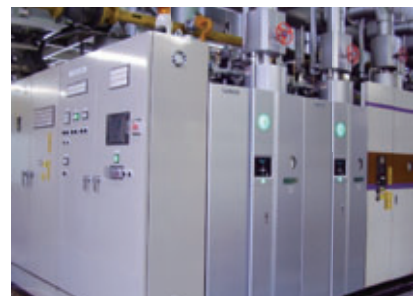
更新した小型貫流ボイラー（手前2台）
