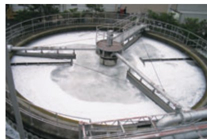
総合排水処理装置
