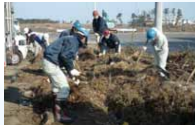
仙南支店の前に積み上がった 瓦礫やヘドロの除去作業
