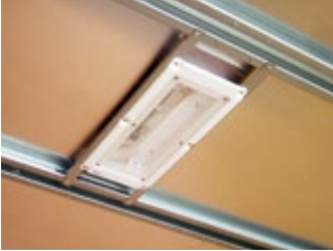
⑧室内蛍光灯
